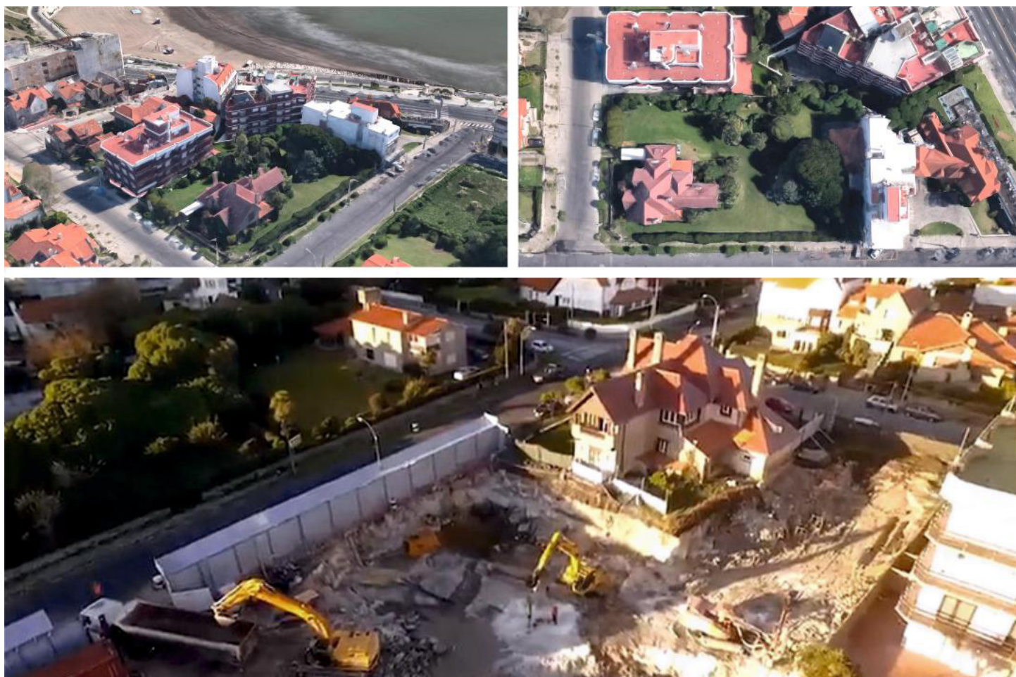
Imagen 4: Arriba, emplazamiento del chalet Ave María; abajo, estado de obras en 2019. Fuente: composición de los autores basada en imágenes de Google Earth y capturas de imágenes de obra ( https://www.facebook.com/watch/?v=2399299510306377 ).
